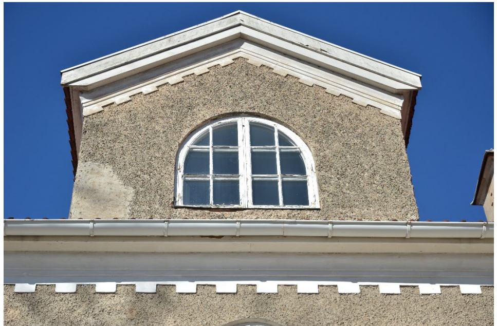
Bild 3. Två av lägenheternas fönsterbågar mot väster som var i stort behov av renovering, före åtgärd (SLM D2020-0330).
